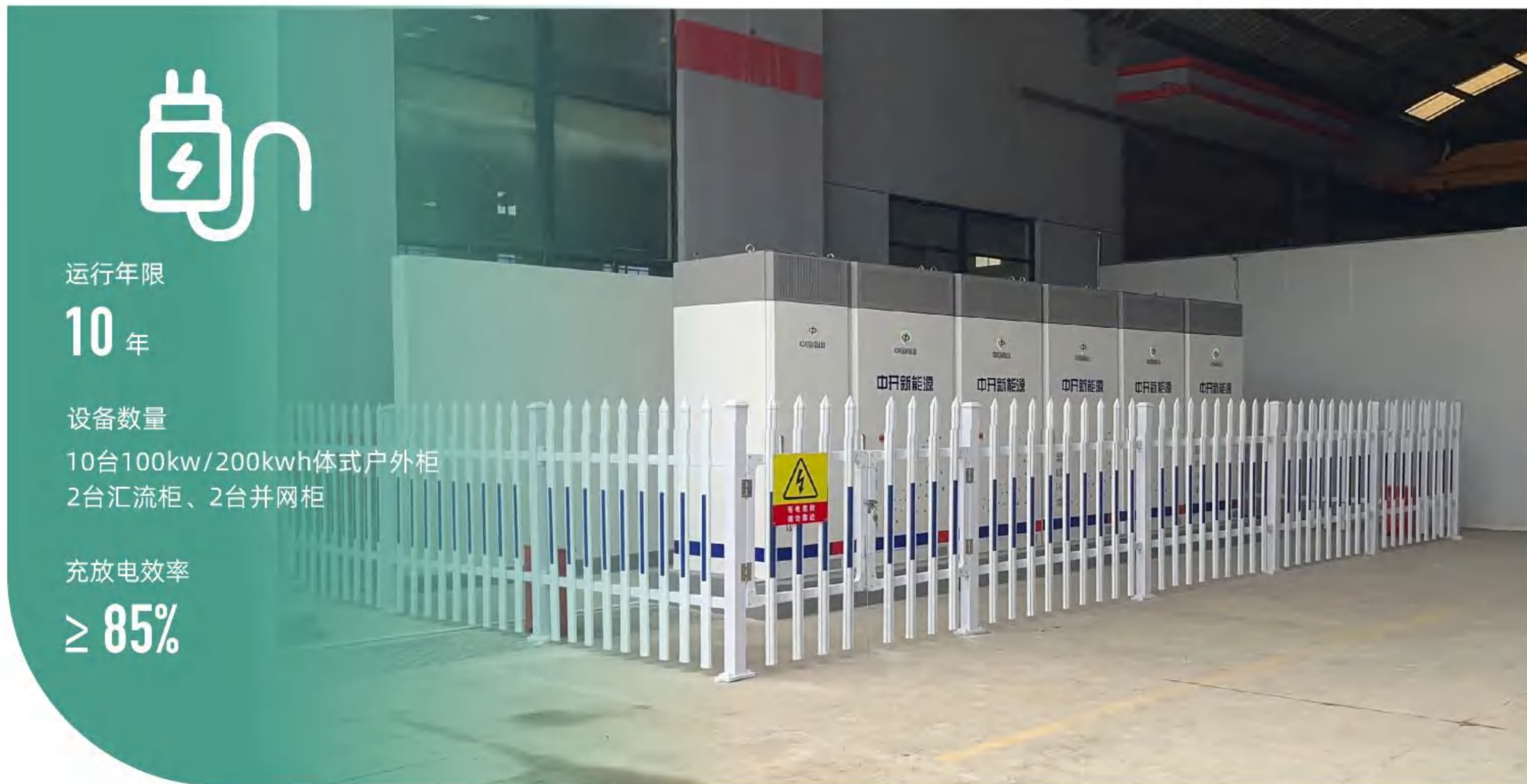
绍兴2MWh工商业储能示范项目
