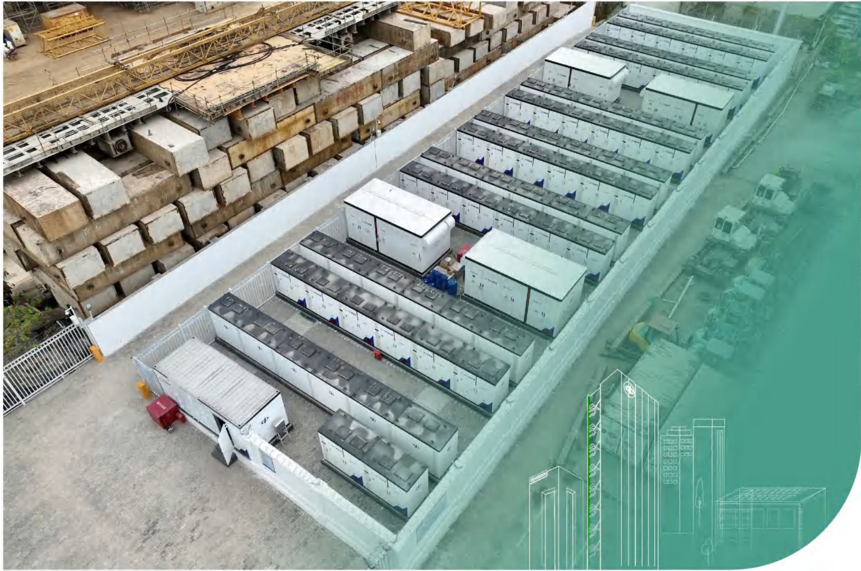
中开新能源赤湾片区储能电站项目
