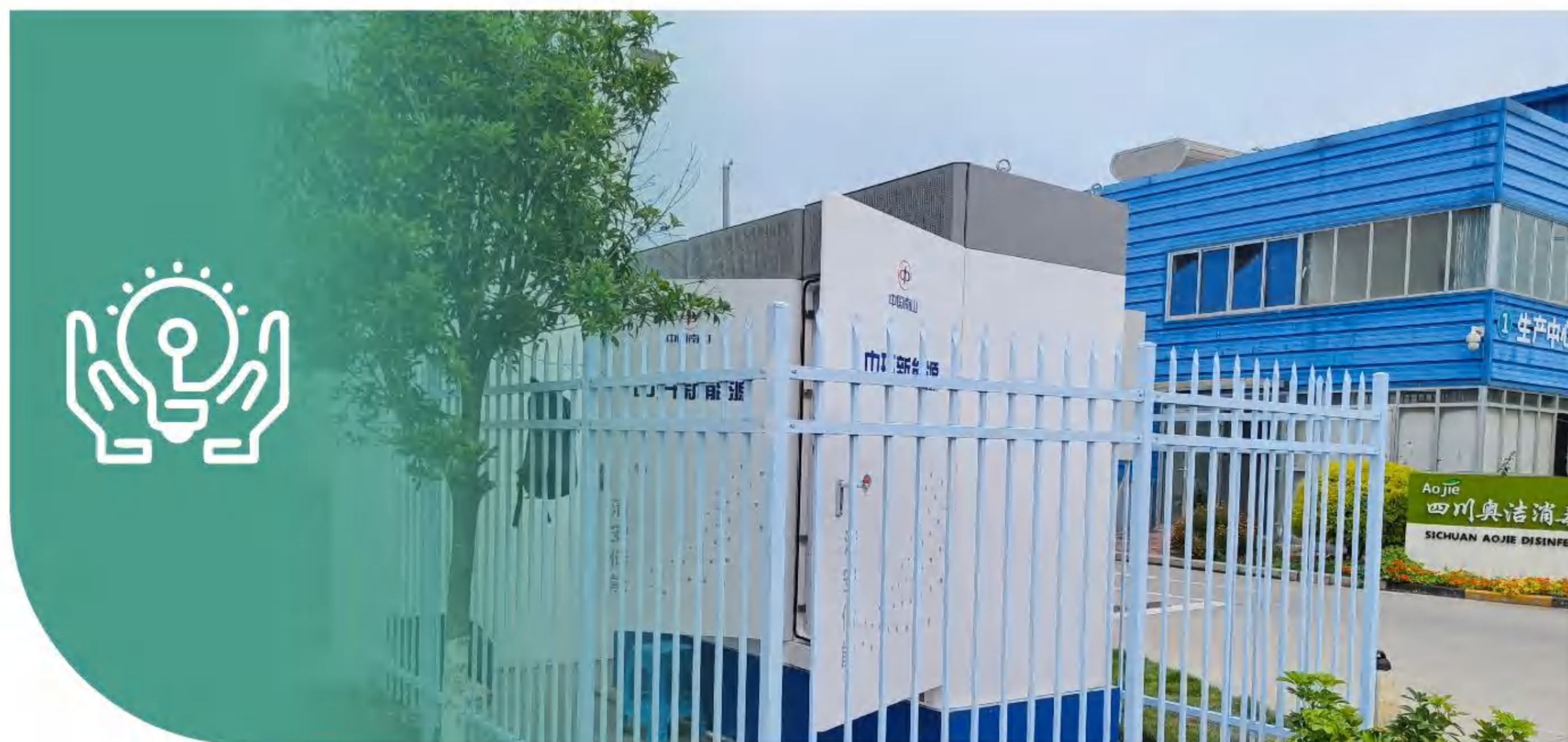
成都新都科技园0.8 MWh用户侧储能项目
